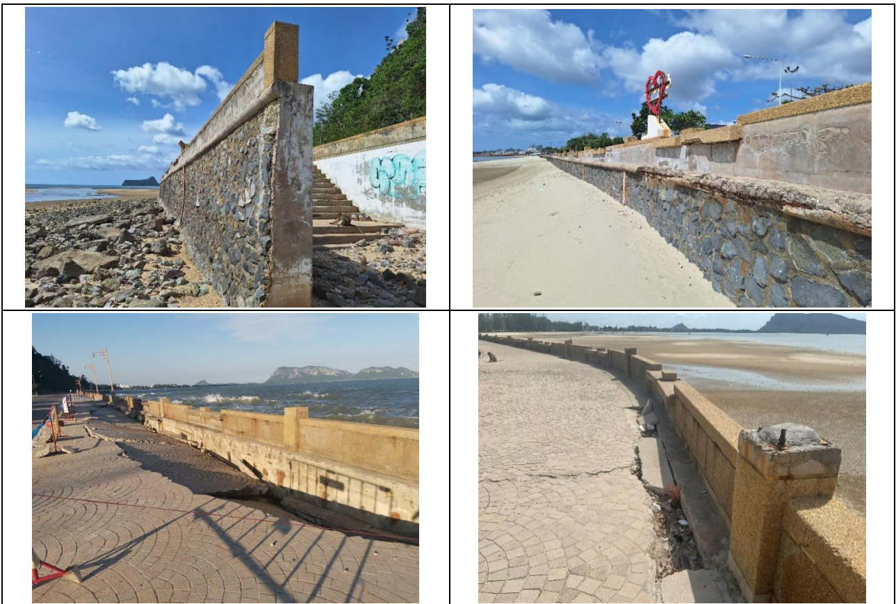
รูปที่ 1 แสดงสภาพชายฝั่งบริเวณพื้นที่โครงการ (ถ่ายเมื่อวันที่ 11 มิถุนายน 2567)
