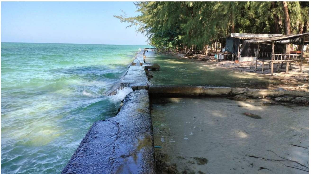
ภาพถ่ายที่ 2 ความเสียหายบริเวณแนวโครงสร้างเขื่อนป้องกันกักเซาะชายฝั่งทะเล พื้นที่ชายฝั่งทะเล บริเวณหาดบ้านขึ้น ตำบลไม้รุ่ต อำเภอลองใหญ่ จังหวัดตราด
